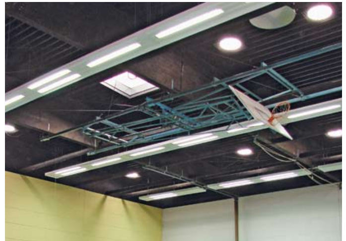
▲ Die runden Auslassöffnungen der Sonnenröhren versorgen die Turnhalle mit diffusem, blendfreiem und schattenarmem Tageslicht
